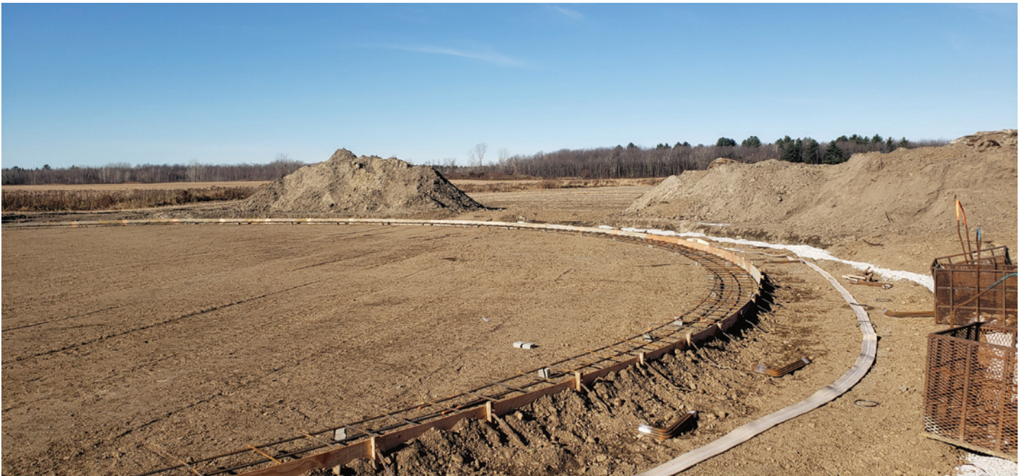
Fond de réservoir prêt pour la coulée de béton avec fibre structurale. © Fusion Expert Conseil inc.
