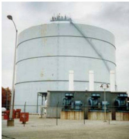
LNG Peak shaving plant (Energy Information Administration)
